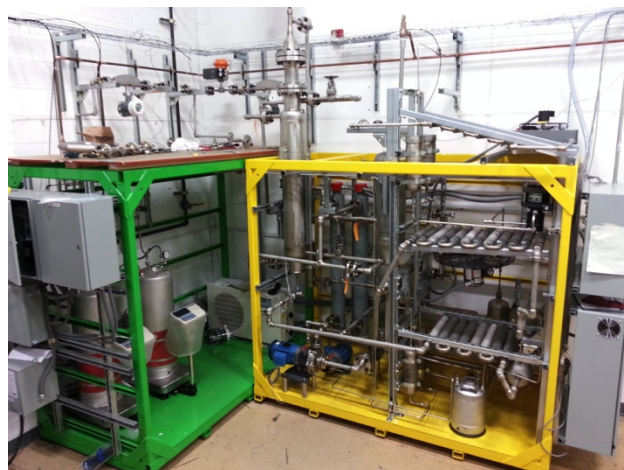
Figure 5. Ceramtec 4'' Fischer-Tropsch Reactor Skid
